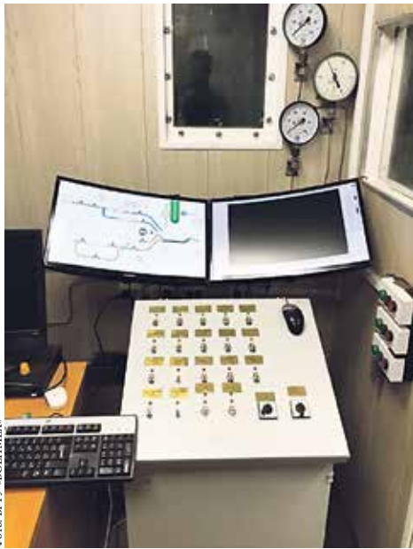
Общий вид пульта управления испытаниями ЖРД
